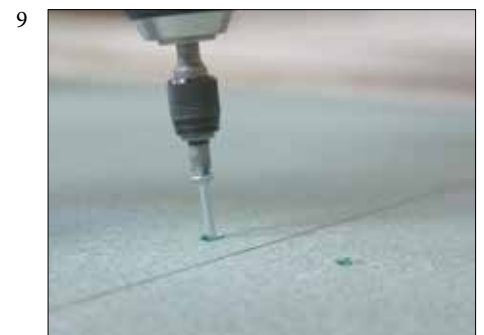
9 Det skal brukes min. 3 skruer på tvers av platene ved hver understøttelse.
