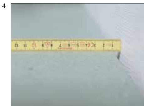
4 Mot faste konstruksjoner - husk at det skal være klaring på min. 10mm.
